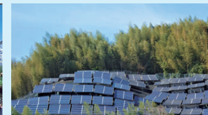
山の斜面など 傾斜のある立地もOK!
